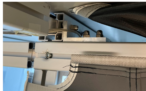
*8 - De två takstolarna ska nu fästas på frontväggens överliggare genom att lägga i en T-skruv och sedan fästa i tredje B-vinkeln från respektive kant.
