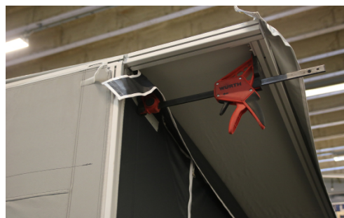
*7 - Spänn upp yttertaket på utsidan genom att tvinga ut de yttre takstolarna både vid front- och bakväggen.
